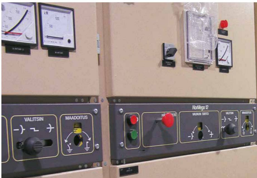
Katkaisijakentän ohjauspaneelissa on vakiona ohjauspainikkeet katkaisijalle ja hätä-seis-kytkin
