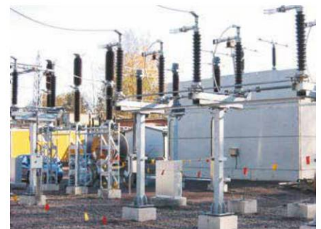
Vattenfall Oy:n Karkkilan sähköasemalle on asennettu NorMega -vaunukatkaisijakojeisto.
