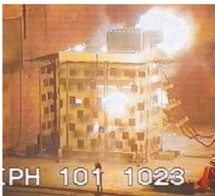
NorMegan tyyppitestauksiin kuului myös valokaaritestit, jossa testattiin kojeiston turvallisuutta äärimmäisissä olosuhteissa
