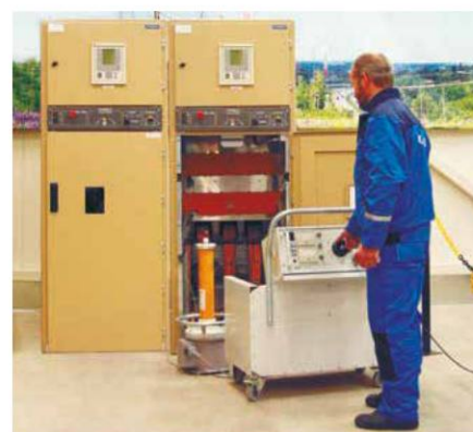
Vaihtojännitetestaus suoritetaan tehtaalla jokaiselle NorMega-kentälle ennen toimitusta
