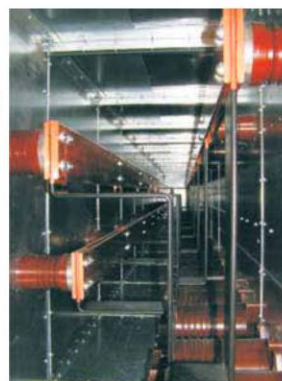
NorMegassa on kojeis- ton mittainen koteloitu kiskostotila.
