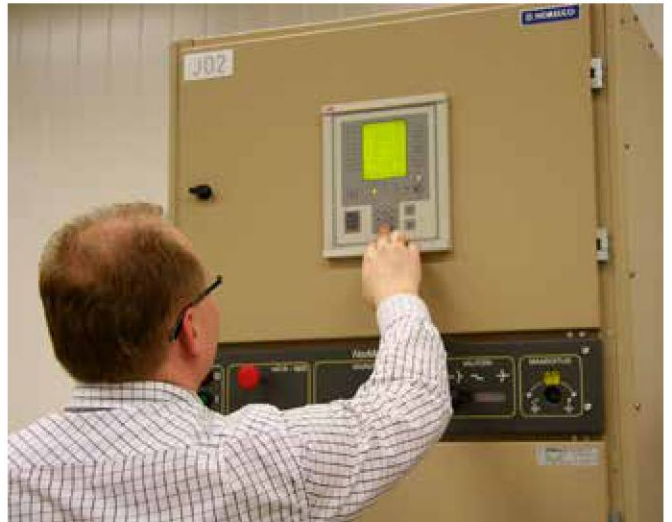
Releistyksen asetukset ja testaukset voidaan suorittaa valmiiksi tehtaalla
