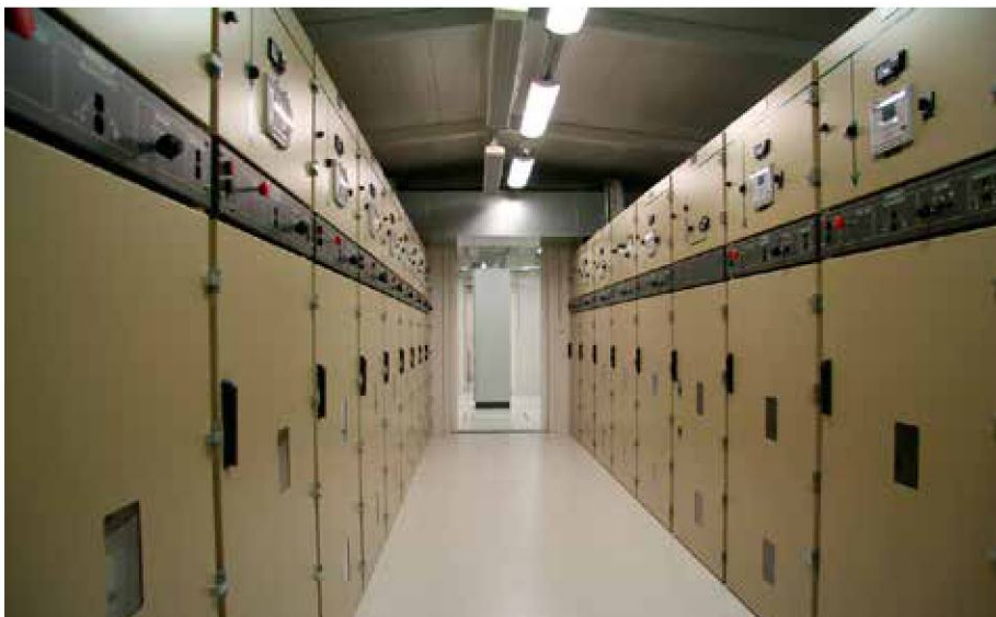
NorMega voidaan rakentaa myös käytävän molemmin puolin ja yhdistää kojeistot toisiinsa NorBus kiskosillalla
