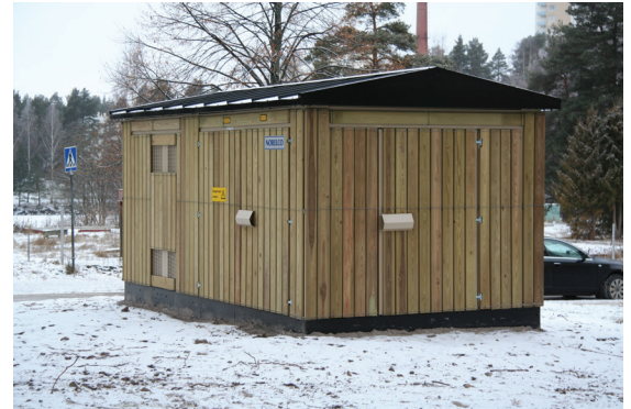
KUVA: NPM 300 sarjan puistomuuntamot voidaan toimittaa myös lautavuorauksella
