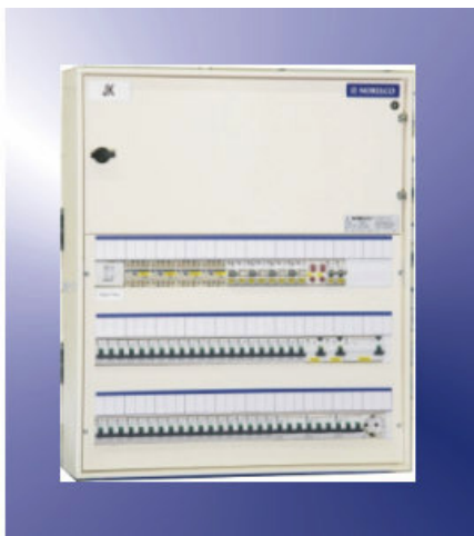
KUVA: Seinälle kiinnitettävä 600x724mm kokoinen Norline-ryhmäkeskus
