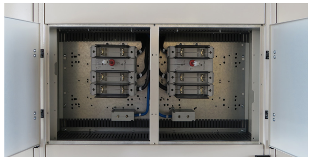
KUVA: Kytkinvarokkeet ja kompaktikatkaisijat saadaan pakattua tehokkaasti keskukseseen
